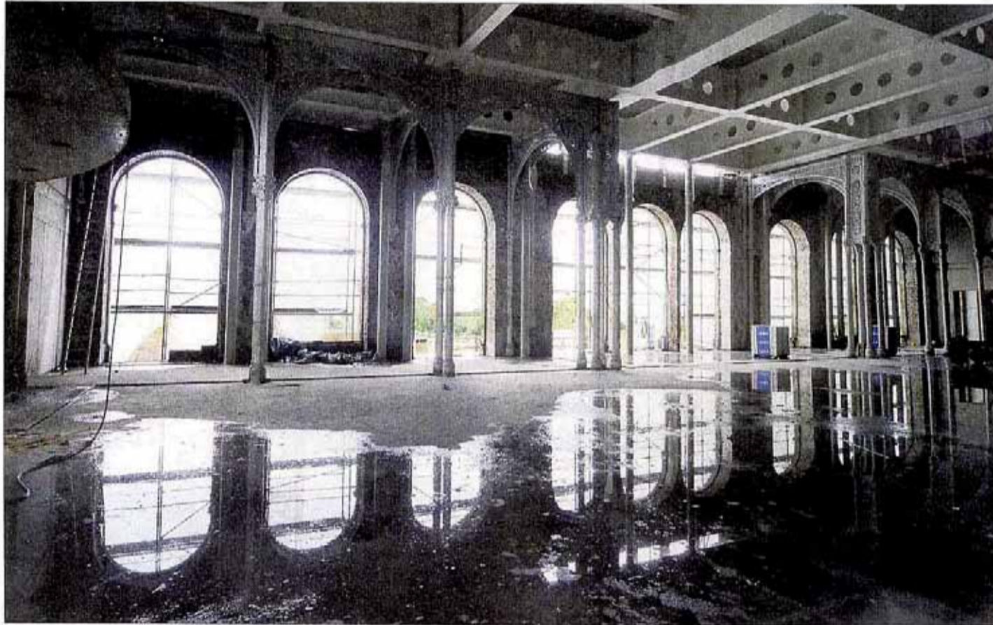
Das Grundgerüst mit Zierfeilern im imposanten Saal steht, in wenigen Wochen wird das Dach der „Flora“ errichtet. (Fotos: Gauger)
